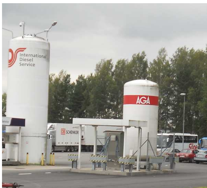
Tankställe för flytande koldioxid (LIC) i Lidköping
