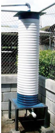
Ett svavefilter med järn från Viogaz i Costa Rica
