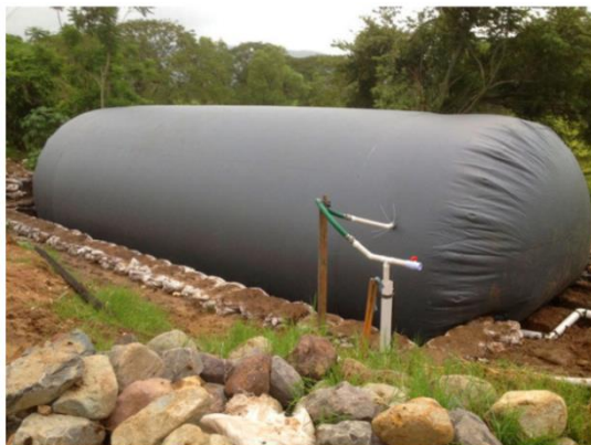
Biogasanläggning av slangtyp ca 20-50m 3
