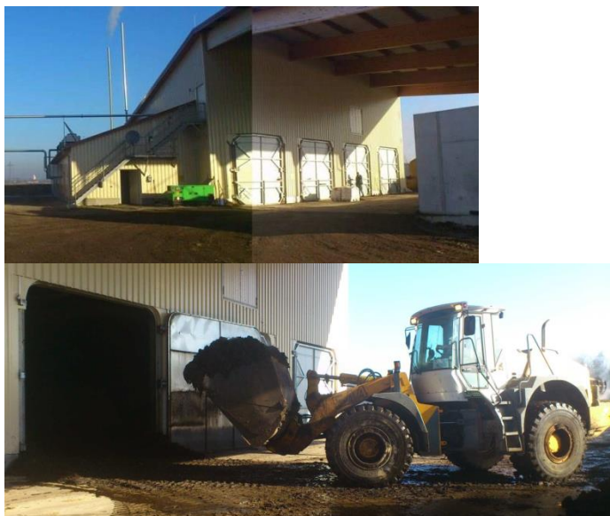
Torrötningsanläggning som rötar 12000 ton hästgödsel/år i Tyska Rosenheim i 4 rötkammare av "garage" typ.
