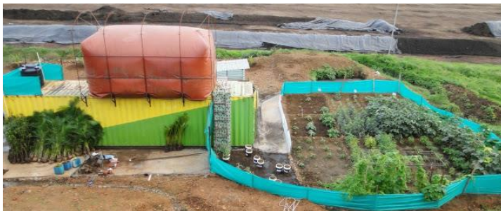
Container baserad biogasanläggning BioBeetle System från Spectrum BioEnergy i Indien ( www.spectrumbioenergy.com )
